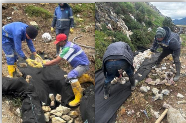
Ilustración 6 mantenimiento de filtros
